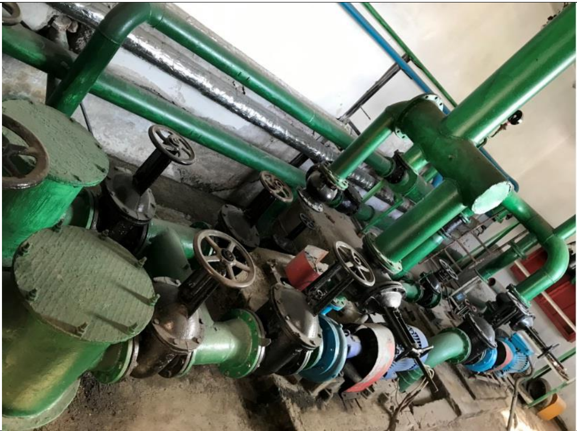
Установка для регулировки подачи воды в бассейны
