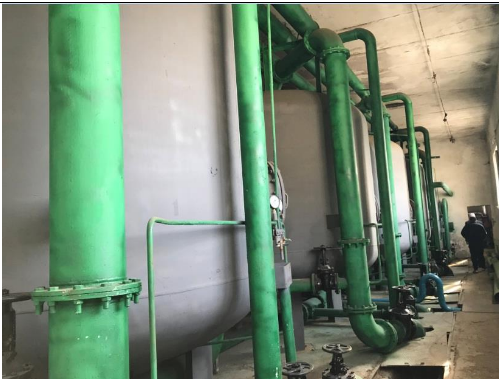
Установка для очистки воды с 4 фильтрами
