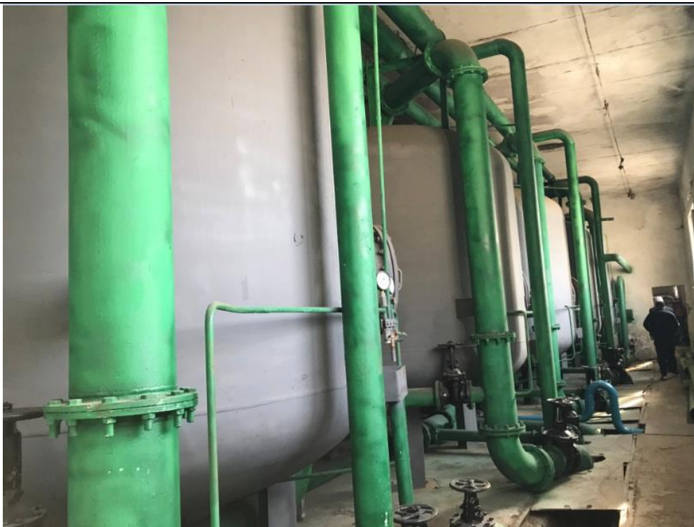
Установка для очистки воды с 4 фильтрами
