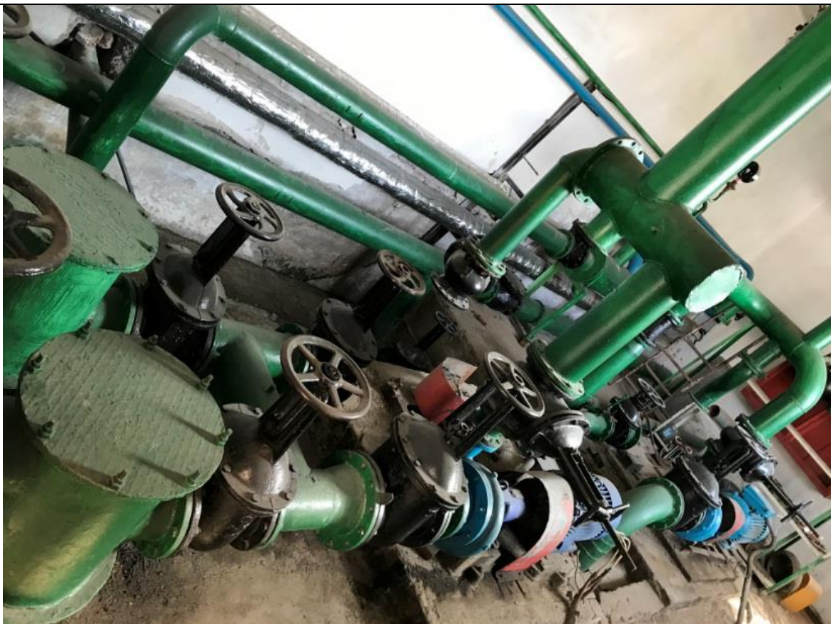
Установка для регулировки подачи воды в бассейны
